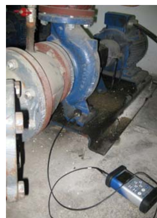
Figura 4. Bomba de impulsión
