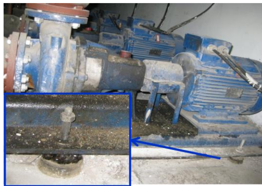
Figura 3. Bomba de reflujo. Detalle apoyo
