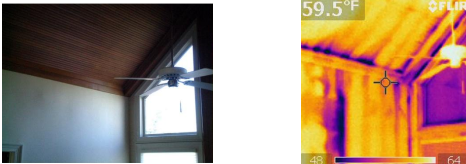
Figura 11. Aparición de infiltraciones en el encuentro entre pared y cubierta.
