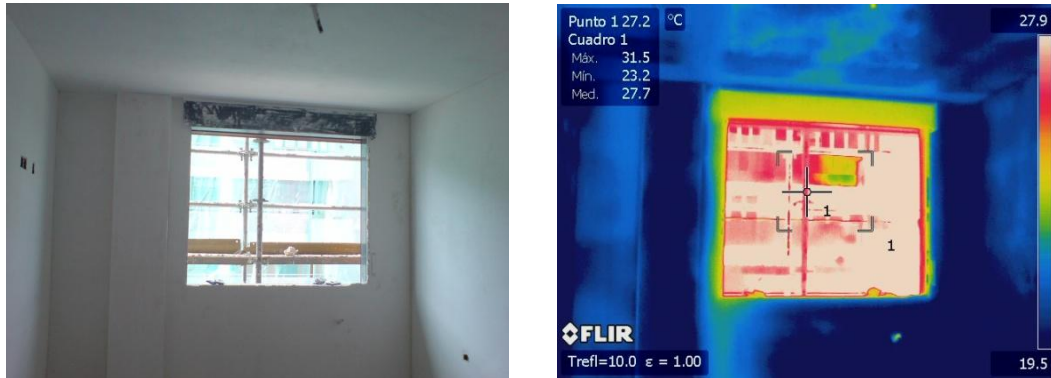
Figura 9. Puente acústico debido a la inexistencia de tratamiento acústico del capialzado.
